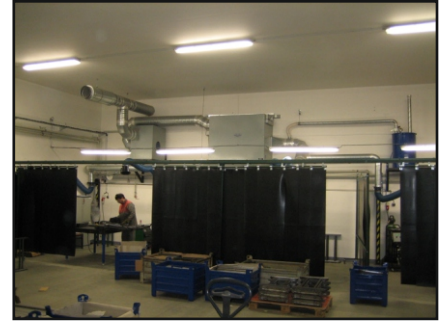
HON - kovo, Skřipov - filtrační jednotka GM3V pro odsávání čtyř ručních svařovacích pracovišť při výrobě kovového nábytku.
