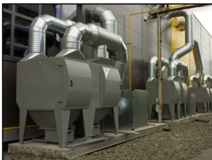
TŘÍDIČ, Šternberk - odsávání svařovny, pálrny a skladu materiálu systémem TCL. Velikost haly je 160x60 m.
