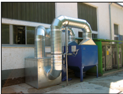
MASSAG Automotive, Fulnek - filtrační jednotka GM9V pro centrální odsávání dvou robotizovaných pracovišť, které svařují metodou MAG a 4 pracovišť pro odporové svařování...
