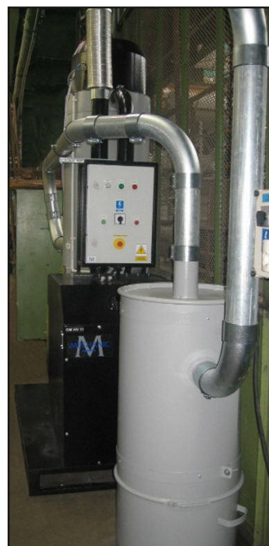
Vysoko podtlaková filtrační jednotka GMHV 1000 pro odsávání plastových pílín vznikajících při obrábění konců hadic pro automobilový průmysl. V popředí je velký zásobník plastových pílín.
