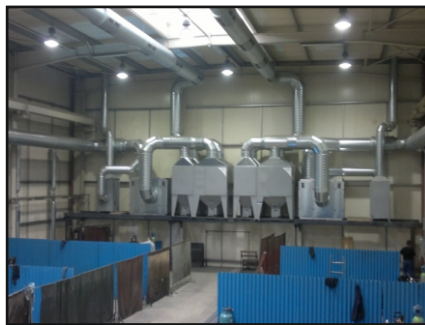
Q-TECH, Bílina - dvě filtrační jednotky GM15 pro centrální celoplošné odsávání svařovny systémem TCL.
