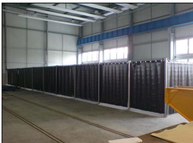
ELFE s.r.o. - svařovací boxy na nové provozovně. Zde jsou veškeré stěny svařovacích boxů tvořeny tmavou lamelou T75M.
