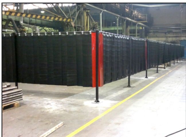
Zeppelin CZ s.r.o., Ostrava - řešení svařovacích boxů na hlavní svařovně. Stěny kolem svařovacích boxů jsou tvořeny lamelami.
