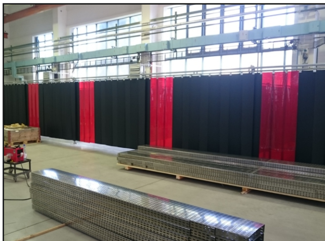
ROSTEX VYŠKOV s.r.o. - svařovací boxy, kdy boční stěny jsou tvořeny zástěnou T75M, vstup do boxů je rovněž přes lamelovou stěnu.
